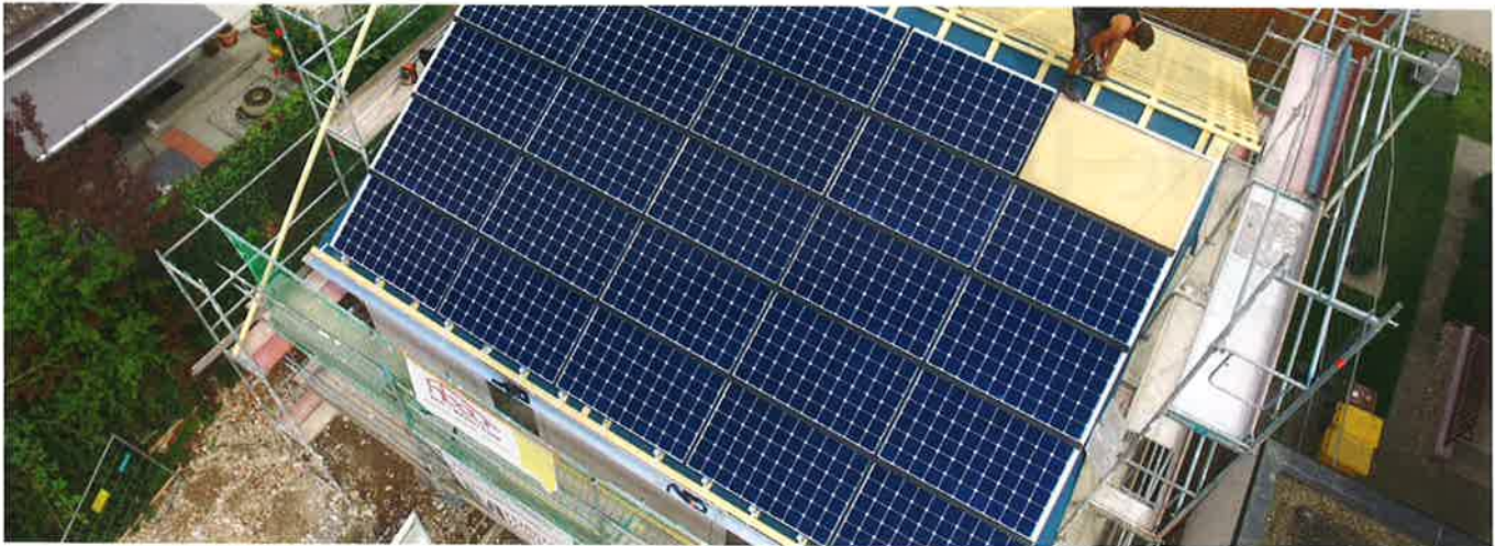
Photovoltaikanlage auf dem Dach / Foto: © Lucas Neddermann
